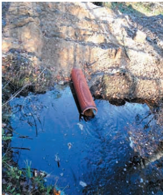
Fot. 25. Widok na groblę z rurą umożliwiającą odpływ nadmiaru wody z torfowiska Sołtysek (listopad 2012)
