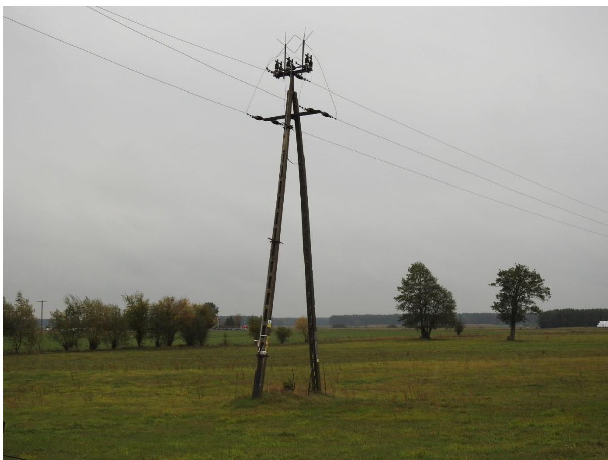
Fot. 7. Przykład zainstalowanych zabezpieczeń na stacji odłącznikowej
