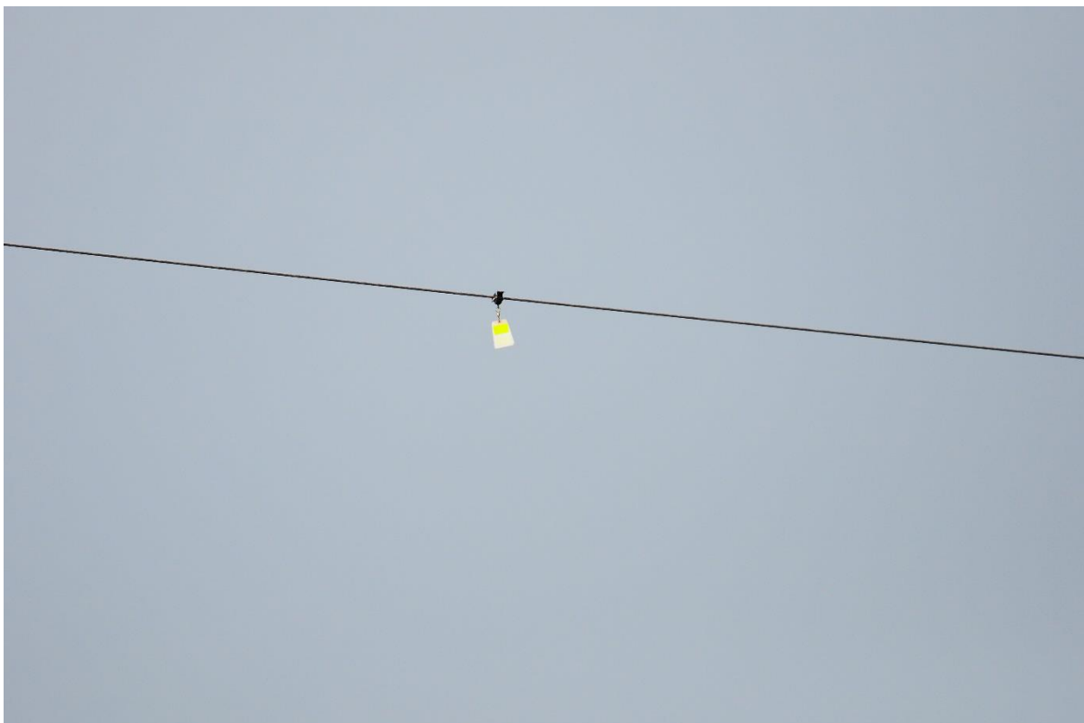
Ryc. 3.4. Znacznik ostrzegawczy typu FireFly, zamontowany na linii energetycznej przecinającej dolinę Narwi w pobliżu miejscowości Ruś (fot. Rafał Siuchno)
